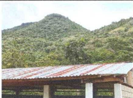
Foto 1: Se pueden observar láminas acanaladas oxidadas, por lo que necesita sustitución
