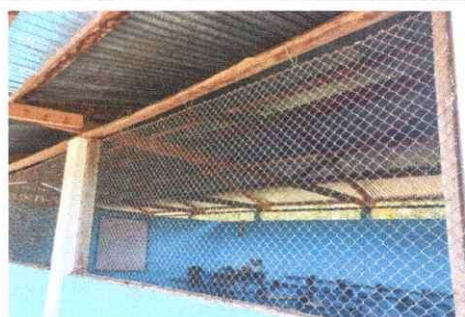
Foto 4: Se observan ventanas con marcos de madera, necesita sustitución por metal
