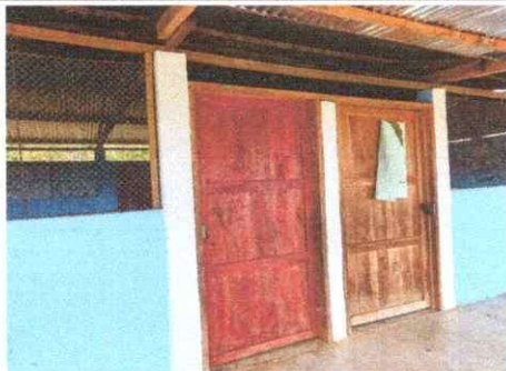
Foto 3: Se observan puertas de madera que necesita sustitución por metal
