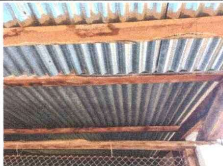
Foto 2: Se observan estructuras de techo de madera muy deteriorado
